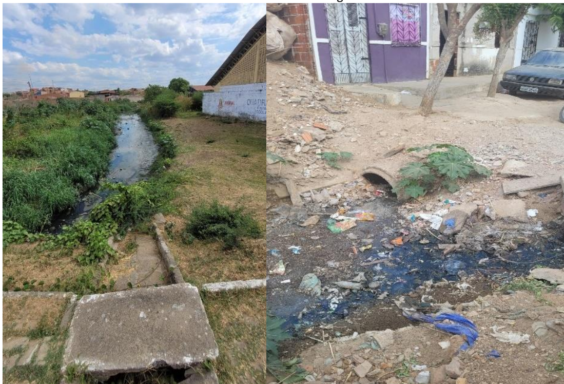
FIGURAS 6 E 7. Área de Alagamento
